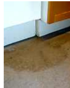
Det er ikke alle vannskader som er like synlige som denne...
